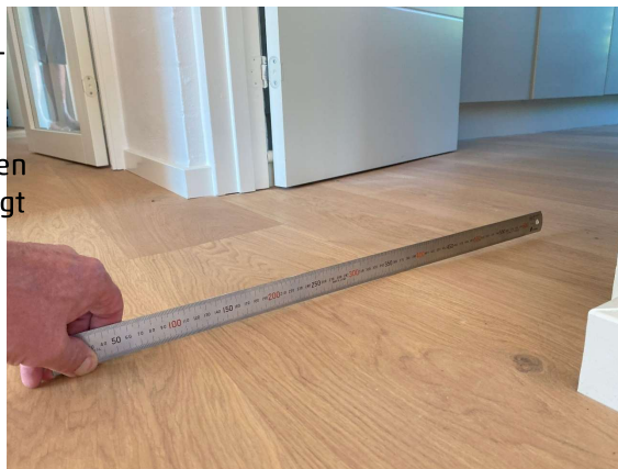
Gulvet rejser ved dørhul pga. kantspændinger / manglende dilatationsfuger / manglende spacers (10-brætsmål).
