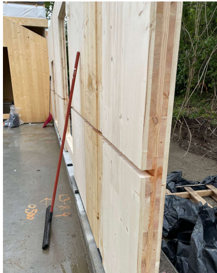
produktionsfejl (tværgående revne)
