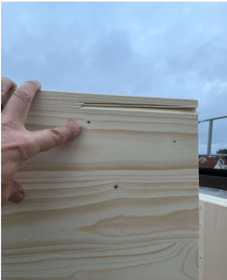
fejl i overflade (skade)
