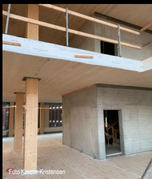
B. Vådrum i støbte kerner ifbm trapper, elevator og teknikskakt
