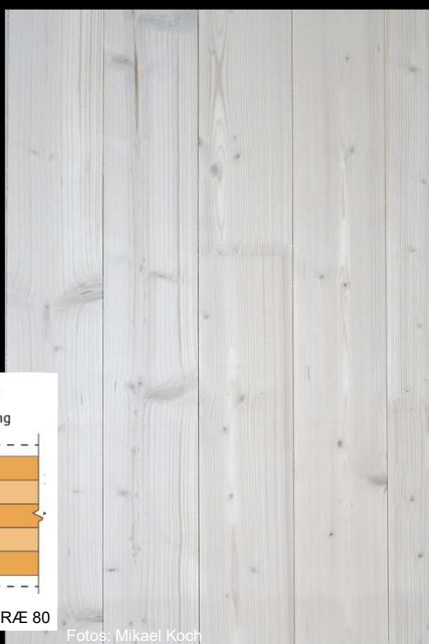
Svindrevner mellem lameller
