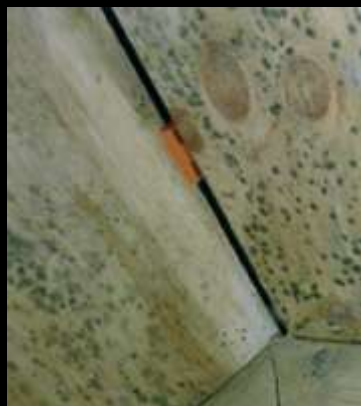
TRÆ 62 Skadet træværk
